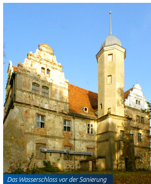
Das Wasserschloss vor der Sanierung
